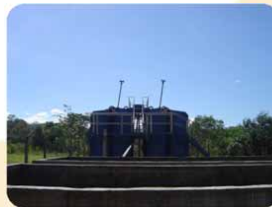
Estação de Tratamento de Esgoto
